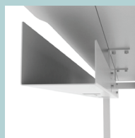
Chemins de câbles
